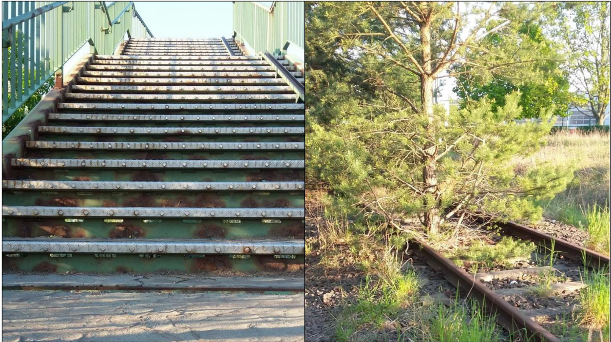
Abbildung 4: Riss- und Korrosionsbildung an der Fußgängerbrücke (links) und vorhandene Vegetation auf brachliegenden Gleisanlagen (rechts)
